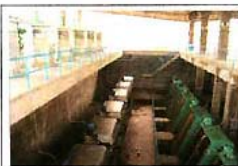
格栅间：除去污水中的大块物体
